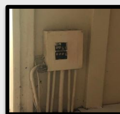
Caja breaker de la casa prefabricada
