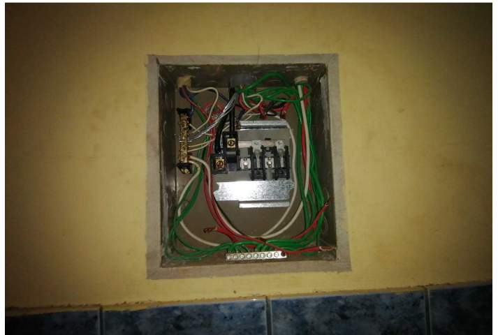
Descripción: Centro de carga sin tapa y breakers eléctricos.
