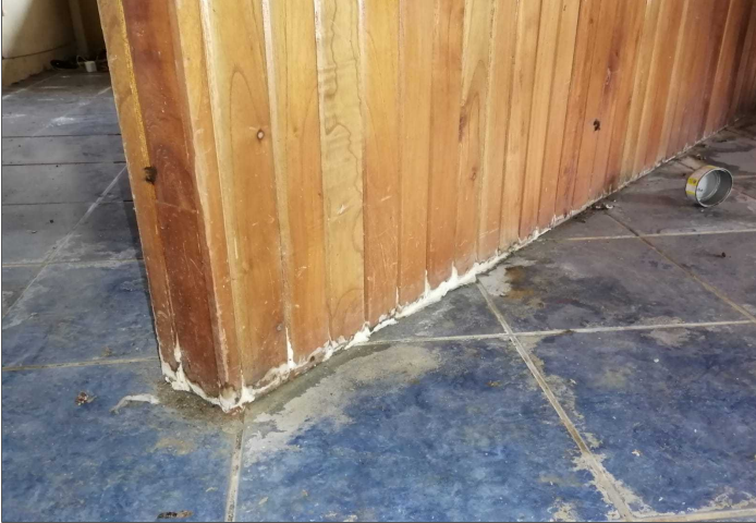
Descripción: Daño en pared de madera y piso por acceso de humedad a la vivienda. Pared entre cocina y do
