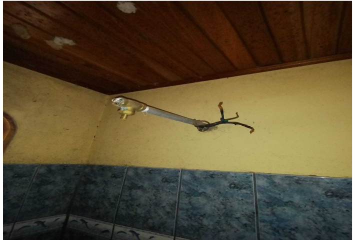
Descripción: Detalle de niple a conectar con ducha, en el baño secundario.
