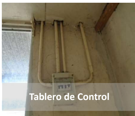
Bajantes Externos Entubados
