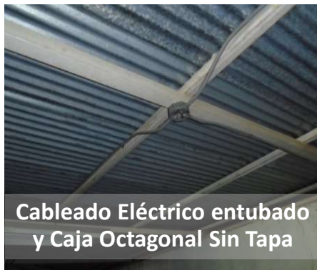
Cableado Eléctrico Entubado
