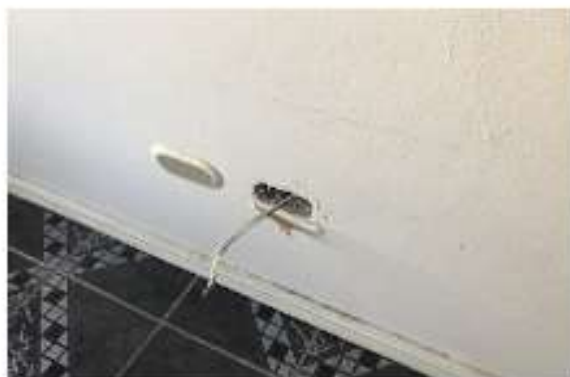
Falta de accesorios eléctricos
