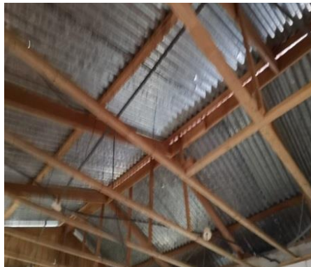
Vista parcial estructura techo - área sin cielo vandalizada
