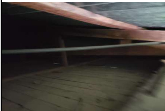
SISTEMA ELECTRICO ENTUBADO
