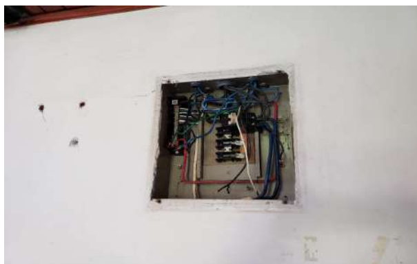
CAJA DE BREAKERS
