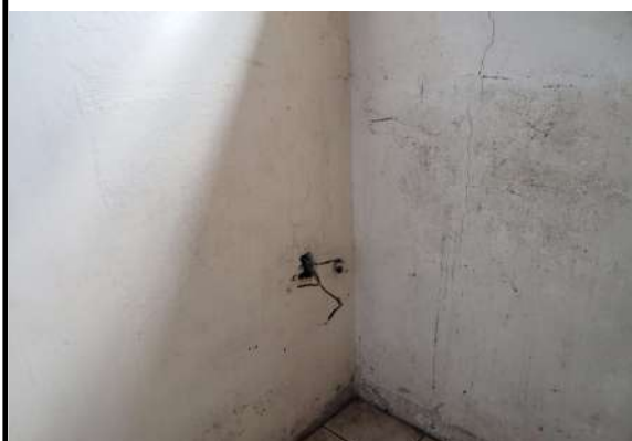
FALTA DE ACCESORIOS ELECTRICOS
