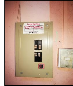
CAJA CIRCUITOS PLANTA BAJA
