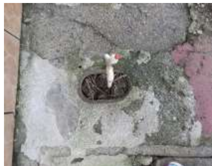
MEDIDOR DE AGUA POTABLE
