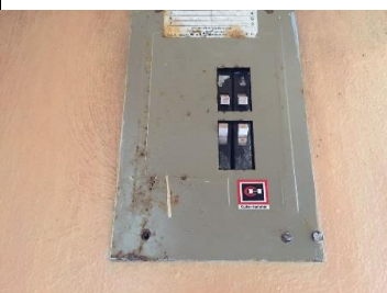
10. Centro de carga
