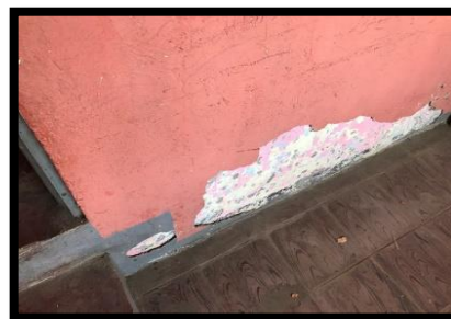
DAÑOS DE PINTURA
