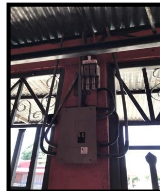
CENTRO DE CARGA E INTERRUPTOR PRINCIPAL
