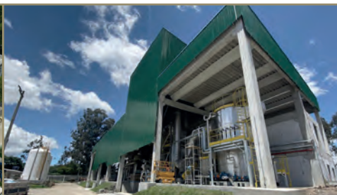
ETE ATUBA SUL SANEPAR Curitiba - PR
