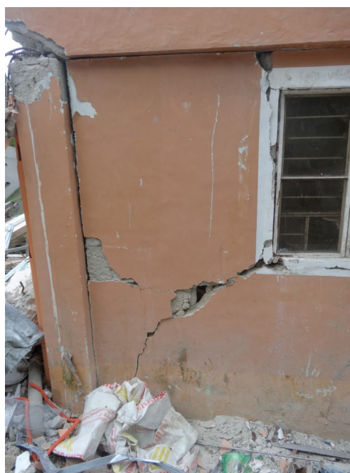
May malaking crack sa magkabilang panig ng pader, Nasisira ang pader kapag kinayod ng kamay
