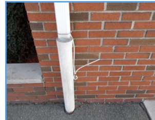
Bajante de agua pluvial
