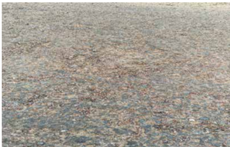
f igura 2 – Desagregação da superfície
