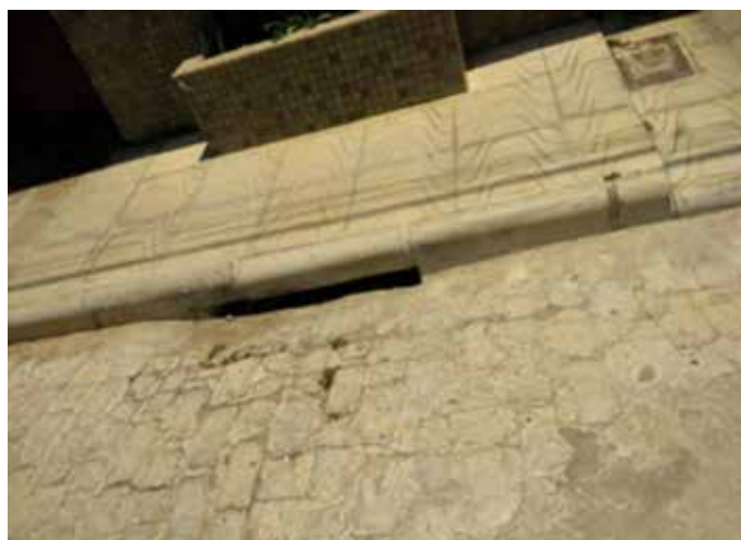
figura 2 – Boca de lobo de guia 1
