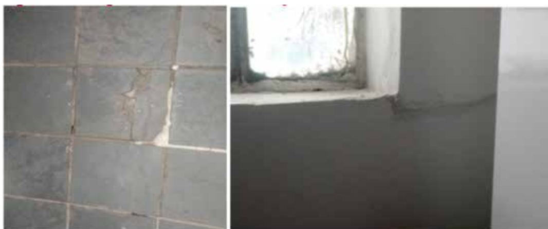
Figura 5 – Patologias encontradas na residência parte 2
