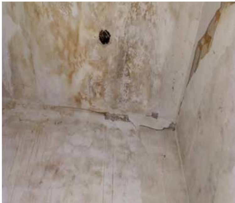
Figura 4 – Infiltração de água na laje
