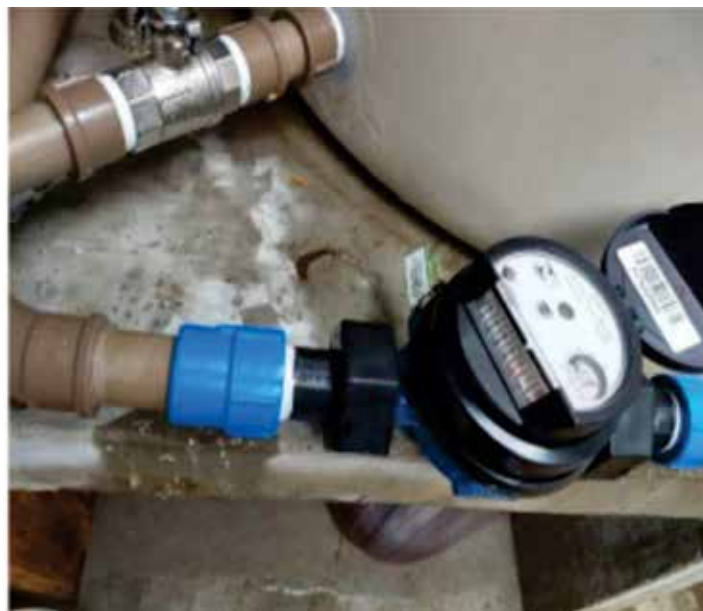
Figura 6 – Hidrômetro instalado para averiguar a quantidade de água.
