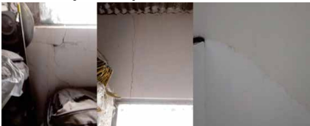
Figura 4 – Patologias encontradas na residência
