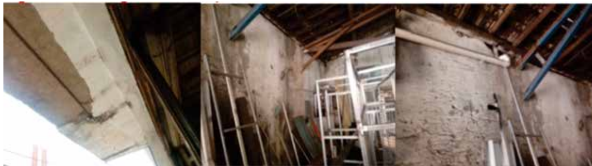
Figura 6 – Patologias na edificação vizinha
