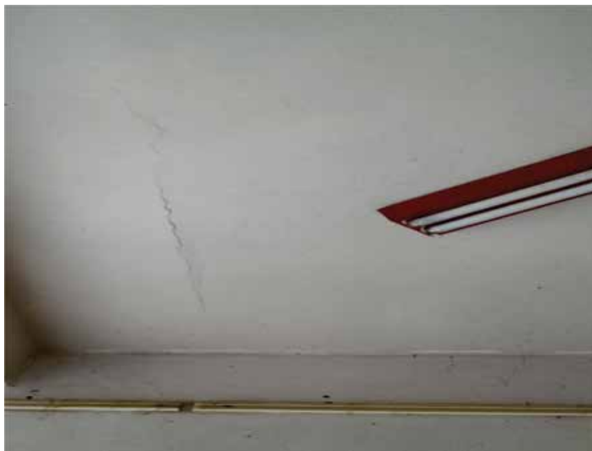
Figura 6 – Fissura presente na laje
