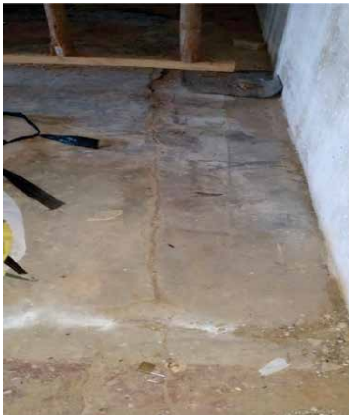
Figura 7 – Fissura no piso de concreto
