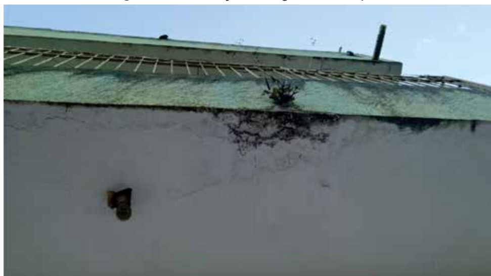
Figura 5 – Infiltração de água na marquise
