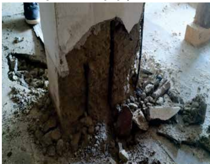
Figura 2 – Desagregação do concreto
