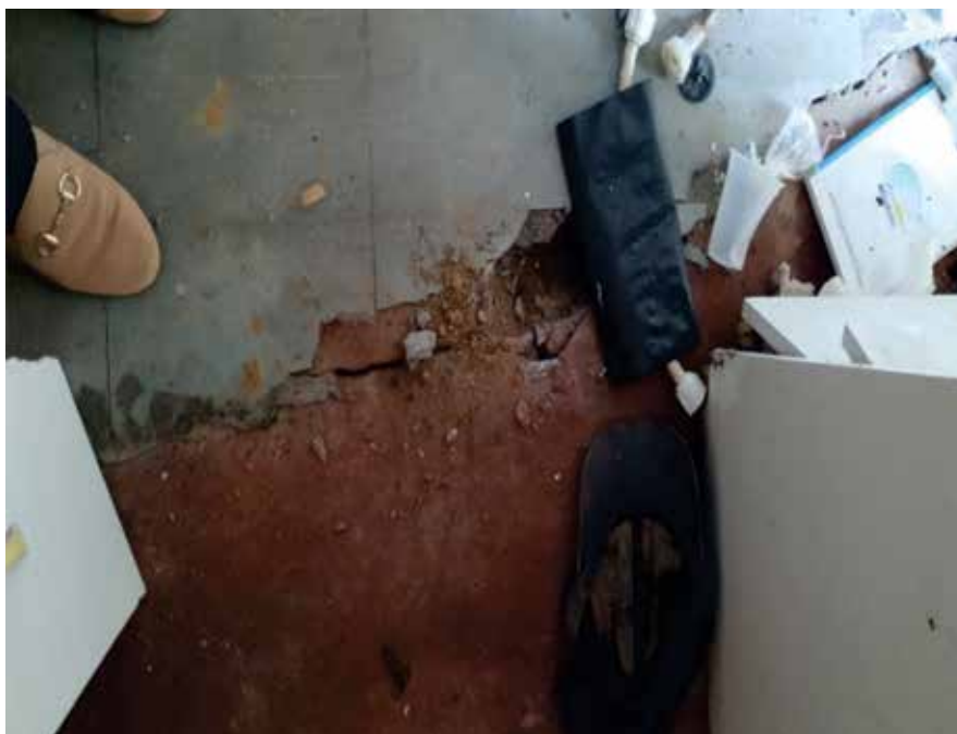
Figura 3 – Abaulamento do piso
