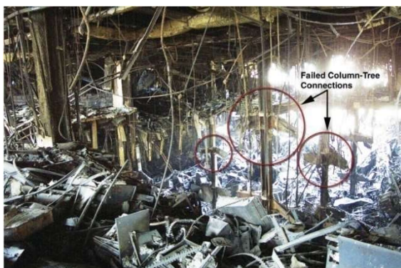
Fallos de conexión parcial y de plantas en el WTC 5 (estudio de incendios del NIST de 2002 que acabaron en colapso total o parcial).
