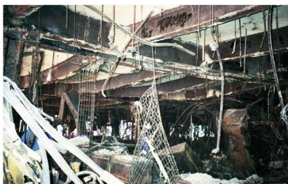
Daños por fuego en el WTC 5 (estudio de incendios del NIST de 2002 que acabaron en colapso total o parcial).
