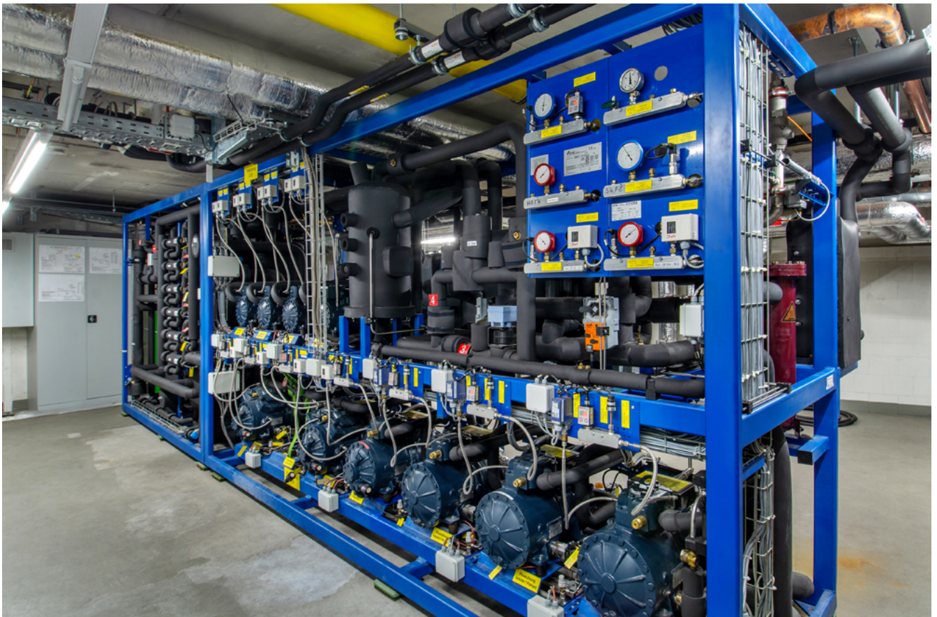
Verdichter und Überwachungstechnik einer CO 2 -Verbundkälteanlage im Maschinenraum. © Valérie Jaquet
