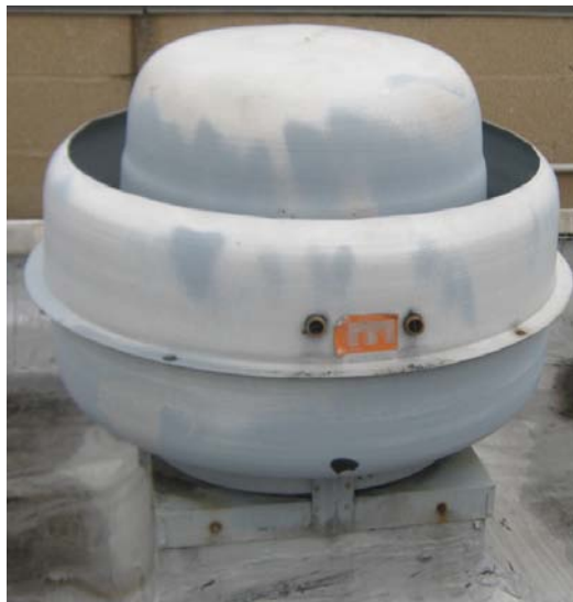
Roof exhaust fan
