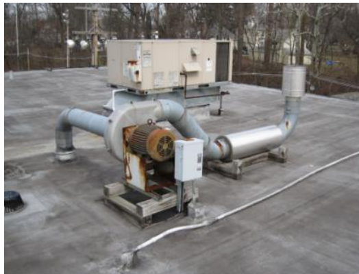
Tail-Pipe Exhaust System Fan
