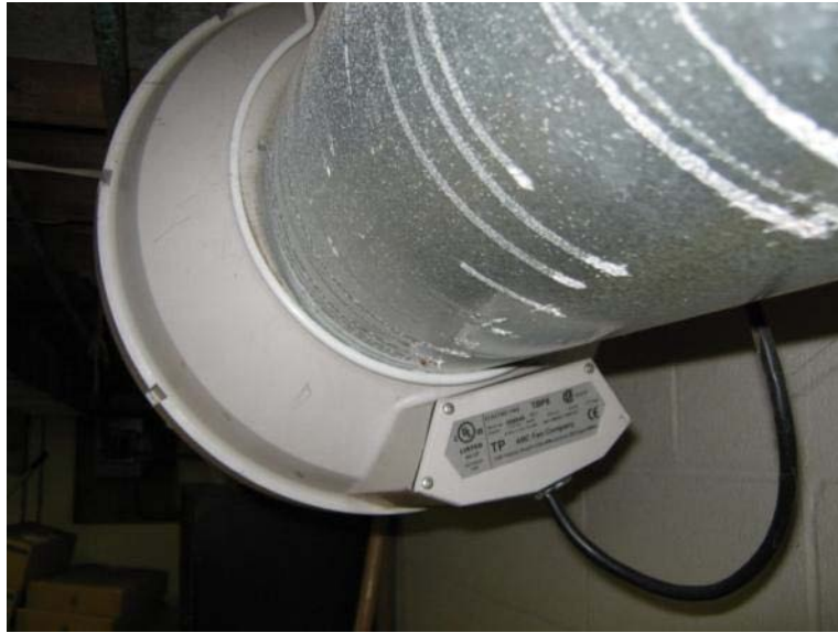
Radon Ventilation Fan
