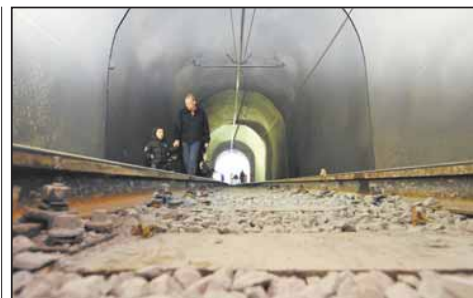
Le coût du chantier s'est élevé à huit millions de francs. HOFMANN
