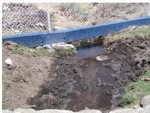
Ingreso de riachuelo a instalaciones.
